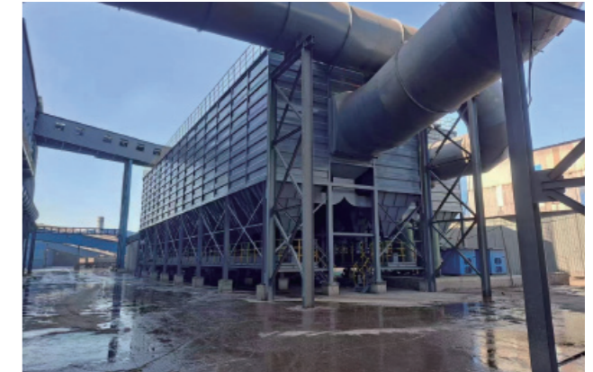
印尼金瑞4*65孔5.5米焦炉除尘地面站
