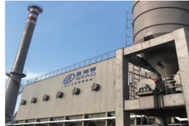
孝义金晖焦化除尘地面站
