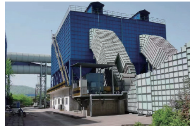
云南沃莱迪电炉除尘地面站
