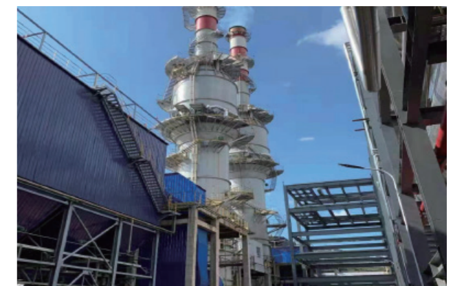
太钢峨口矿业布袋除尘器
