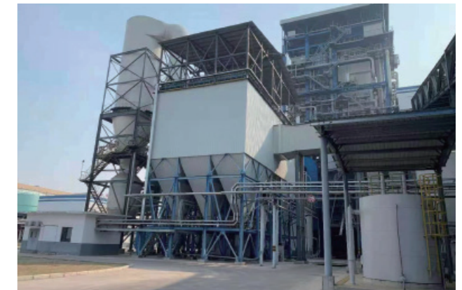
首钢杏山矿业布袋除尘器
